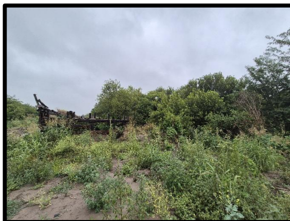
Figura 50 – Vista estructura colapsada del puente original.
