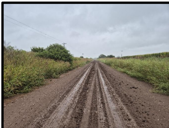
Figura 41 – Estado RPN43 hacia el puente sobre el arroyo el Sauce.
