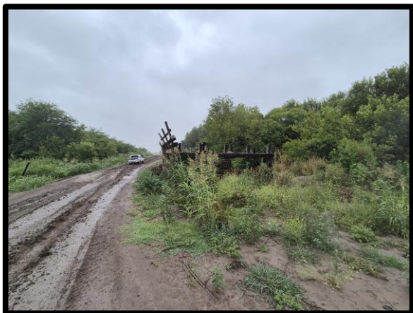
Figura 47 – Vista del cruce del Arroyo El Sauce, donde se observa la estructura colapsada del puente original.
