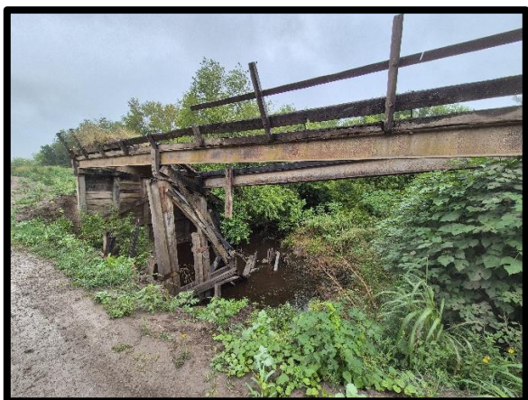
Figura 49 – Vista estructura colapsada del puente original.
